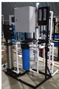
Рисунок 3. Общий вид пилотной установки Figure 3. General view of the pilot plant
